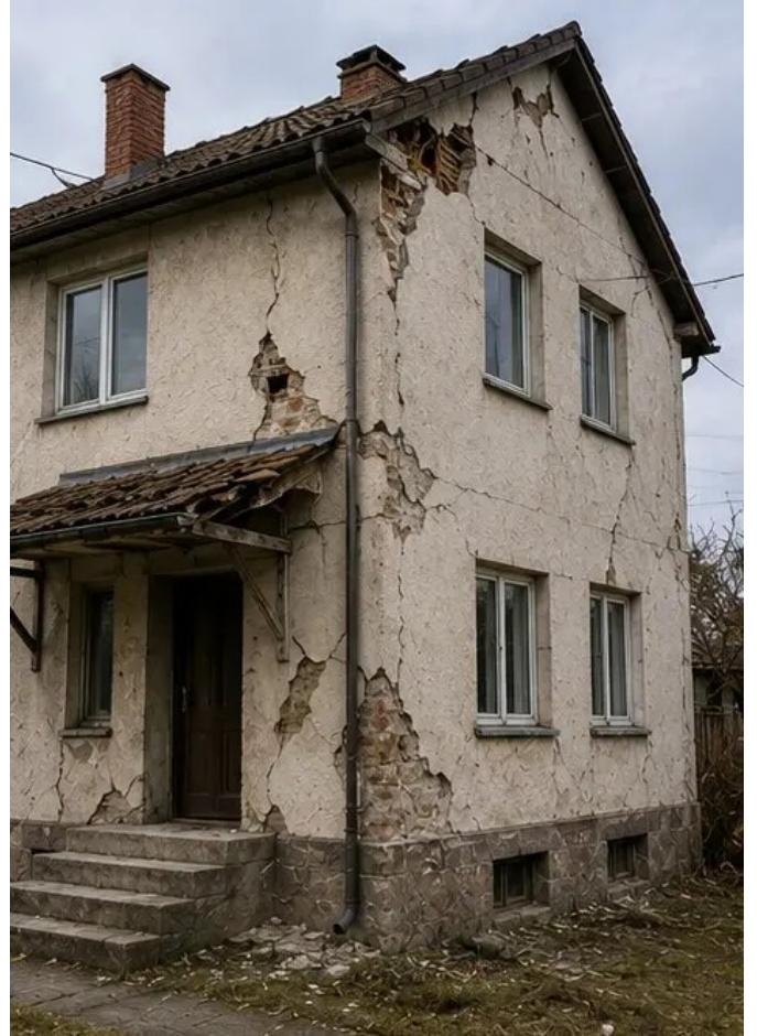
照片 №15 多处损坏位置概览
