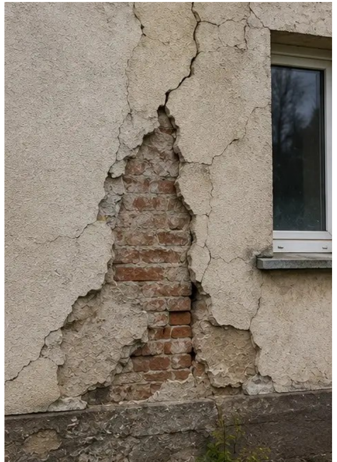
照片 №4 为评估而记录的外墙损坏
