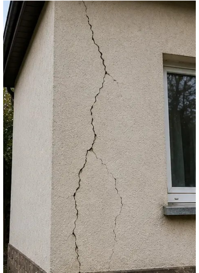
照片 №5 检查过程中记录的结构墙体裂缝
