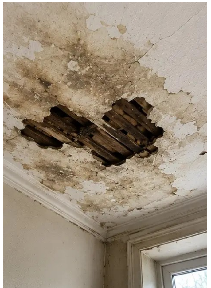
照片 №10 已识别并记录的吊顶损坏
