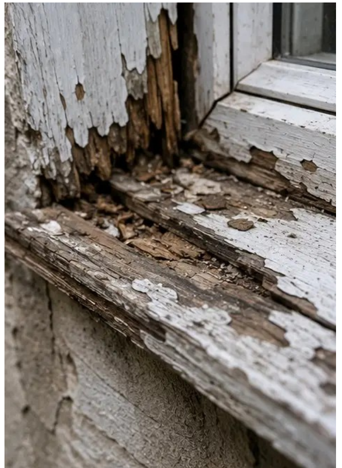
照片 №14 已识别损坏的特写证据照片
