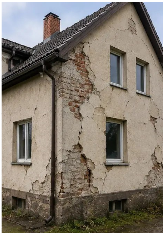
照片 №2 检查过程中记录的外部损坏概览
