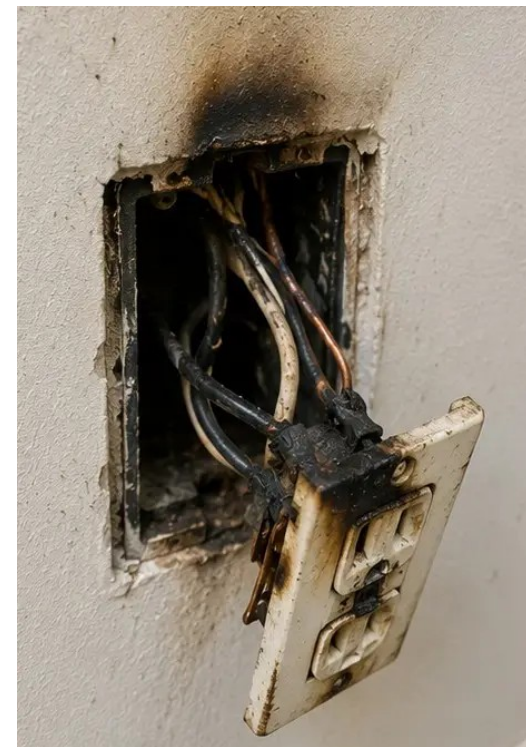
照片 №12 检查过程中记录的电气系统损坏
