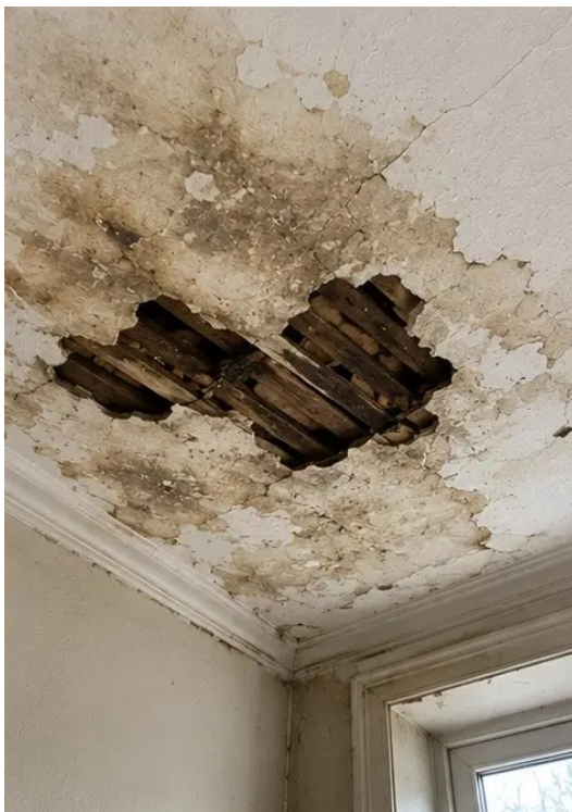
照片 №10 已识别并记录的吊顶损坏
