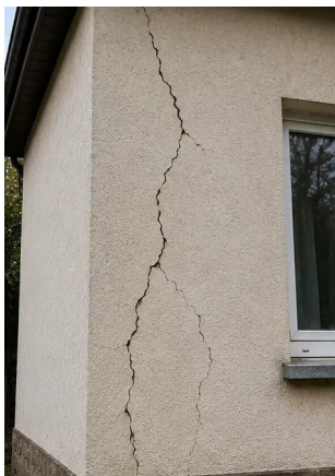
Photo #5. 检查过程中记录的结构墙体裂缝
