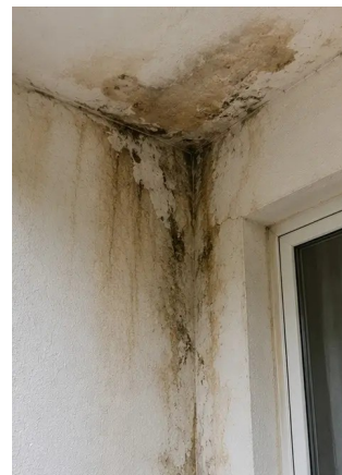
Photo #6. 已识别并记录的水损区域
