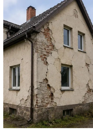
Photo #2. 检查过程中记录的外部损坏概览
