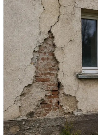
Photo #4. 为评估而记录的外墙损坏
