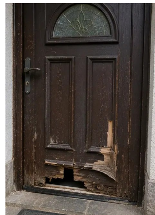
Photo #8. 检查过程中记录的受损入户门
