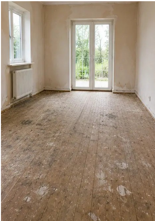
照片 №5 更换前地板状况
