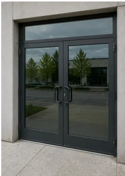
Photo #7. 门状况已检查并记录
