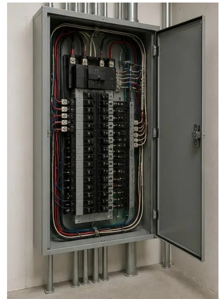
Photo #9. 配电盘状况已记录
