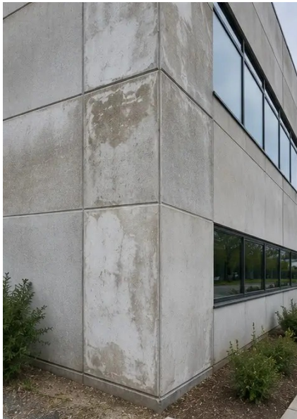
Photo #4. 检查期间记录的外墙状况
