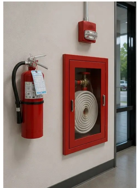
Photo #12. 安全设备已检查并记录
