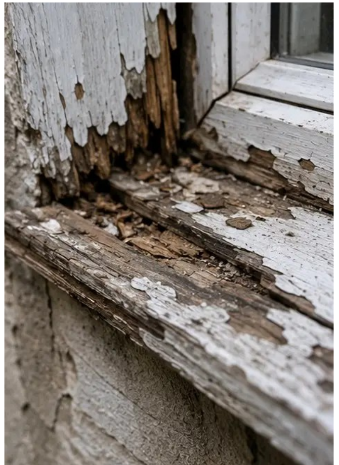
Ảnh số14 Ảnh cận cảnh bằng chứng hư hỏng đã xác định
