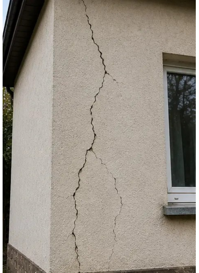
Ảnh số5 Vết nứt tường kết cấu được ghi nhận trong quá trình kiểm tra
