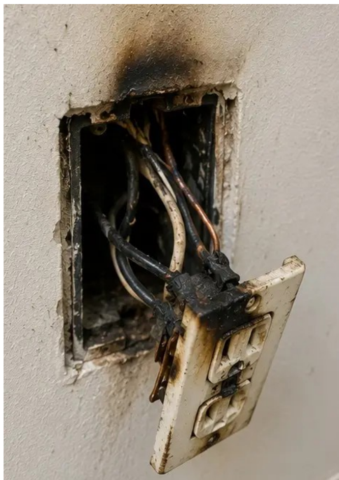
Ảnh số12 Hư hỏng hệ thống điện được ghi nhận trong quá trình kiểm tra
