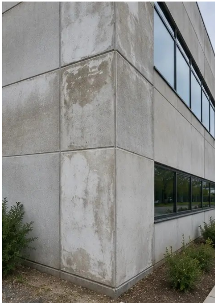
Photo #4. Tình trạng tường ngoài được ghi nhận trong quá trình kiểm tra
