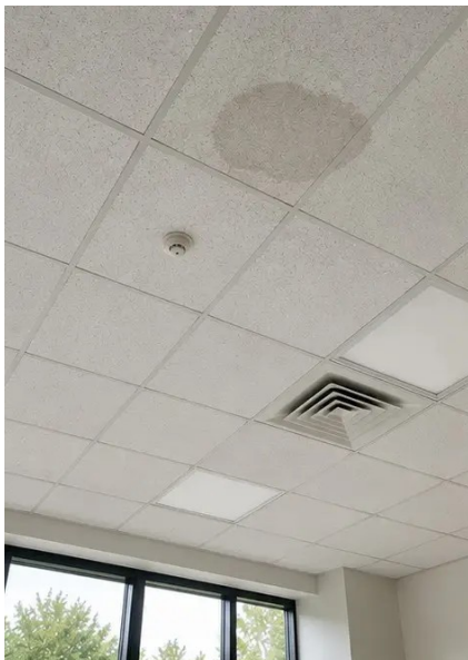
Photo #13. Tình trạng trần được ghi nhận trong quá trình kiểm tra
