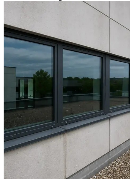
Photo #6. Tình trạng cửa sổ được ghi nhận trong quá trình kiểm tra
