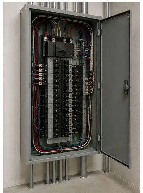
Photo #9. Tình trạng tủ điện đã ghi nhận
