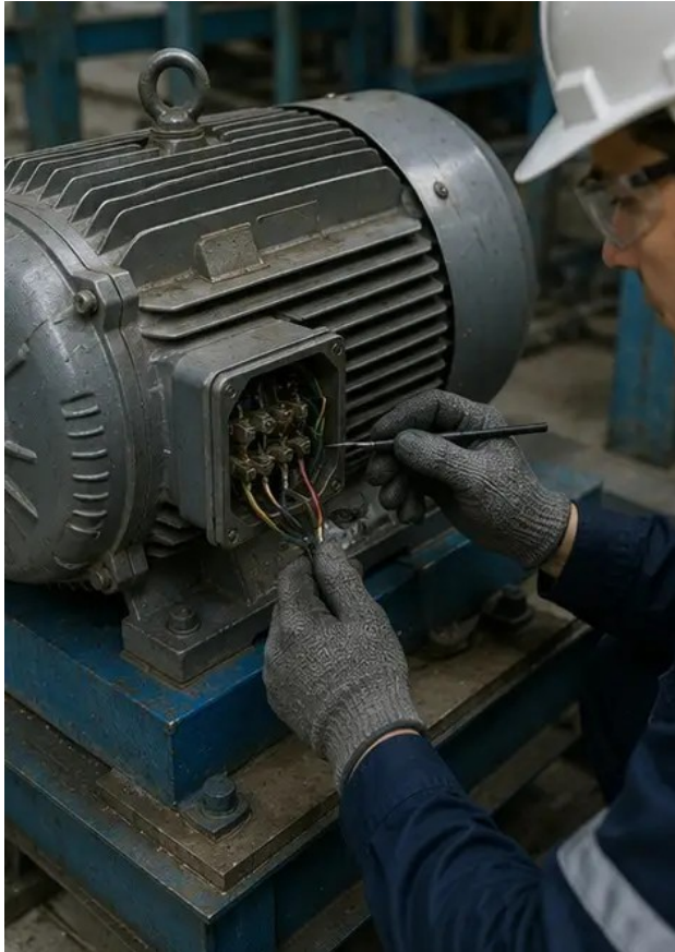
Ảnh số4. Kiểm tra động cơ điện hoàn tất
