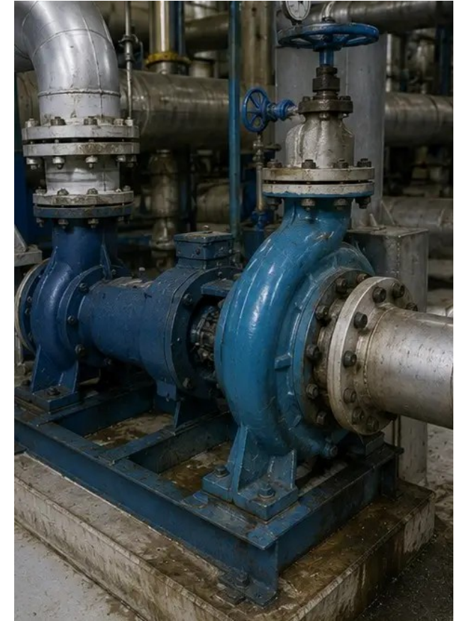
Ảnh số3. Tình trạng bơm công nghiệp được đánh giá trong quá trình bảo trì
