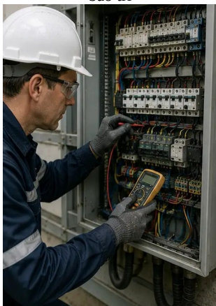
Ảnh số5. Đã thực hiện kiểm tra tủ điện
