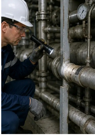
Ảnh số9. Kiểm tra đường ống hoàn tất theo lịch bảo trì
