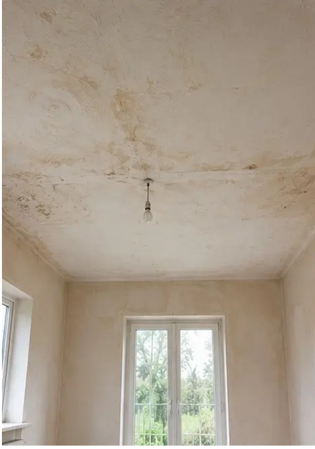
Görüntü No7 Yenileme öncesi tavan durumu
