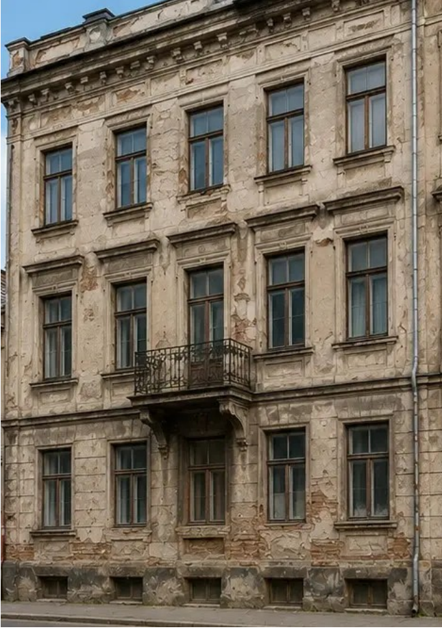
Görüntü No13 Restorasyon öncesi bina cephesi
