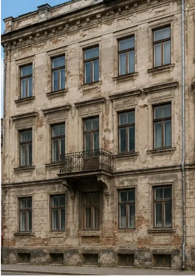
Görüntü No13 Restorasyon öncesi bina cephesi
