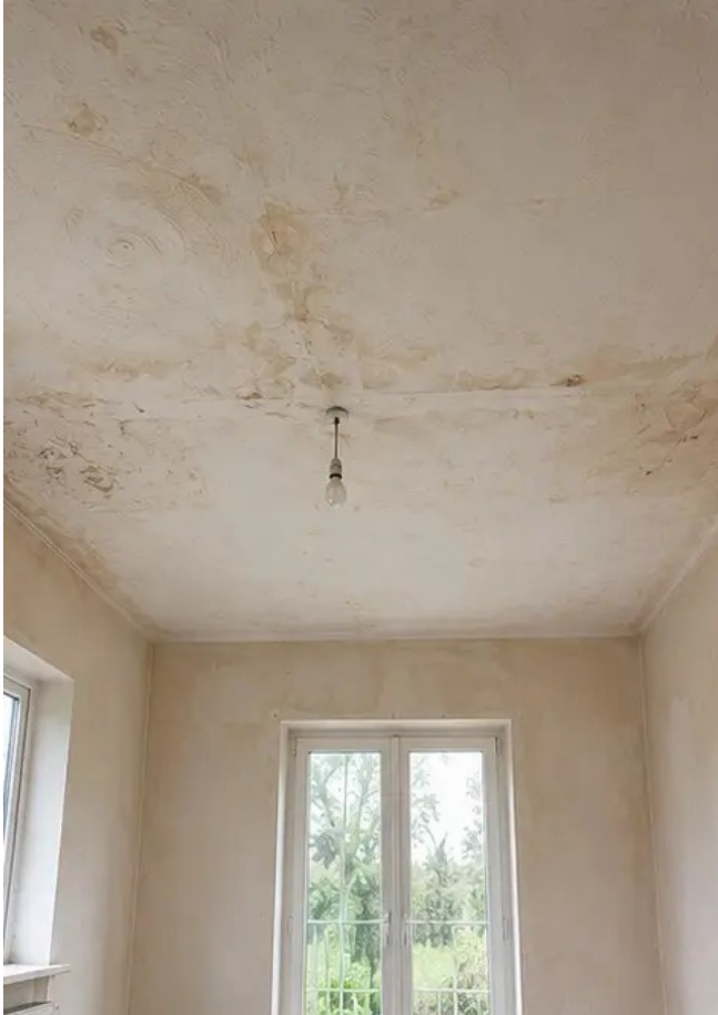
Görüntü No7 Yenileme öncesi tavan durumu
