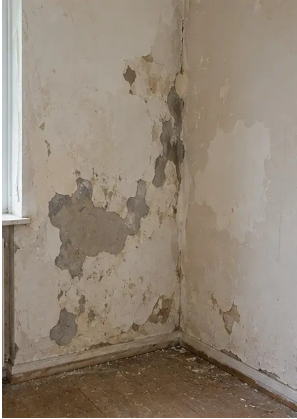
Görüntü No3 Onarım işleri öncesi duvar durumu
