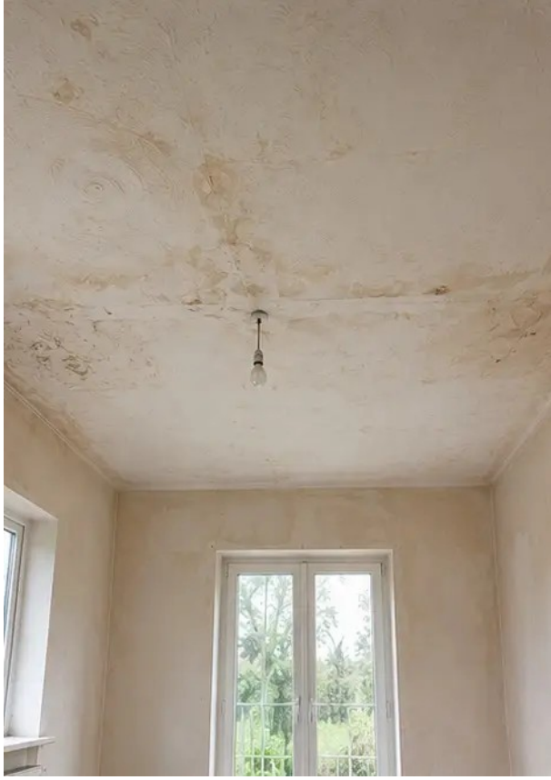
Görüntü No7 Yenileme öncesi tavan durumu
