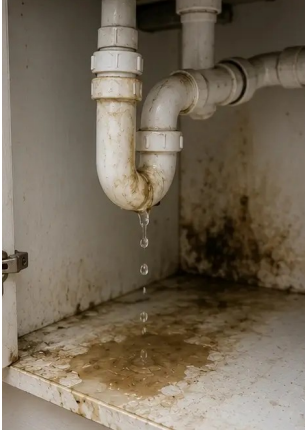
Photo #11. Sıhhi tesisat sızıntı hasarı belgelendi
