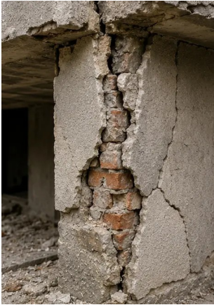
Photo #13. Değerlendirme için belgelenen yapısal hasar detayı
