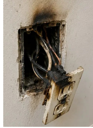
Photo #12. Denetim sırasında kaydedilen elektrik sistemi hasarı
