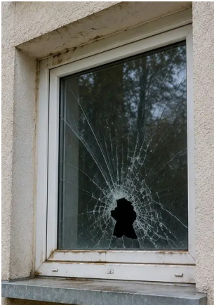
Photo #7. Değerlendirme için belgelenen hasarlı pencere
