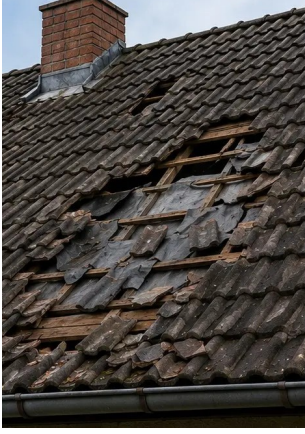
Photo #3. Hasarlı çatı alanı tespit edildi ve kaydedildi
