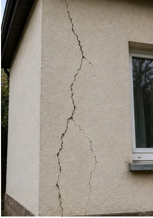
Photo #5. Denetim sırasında belgelenen taşıyıcı duvar çatlakları
