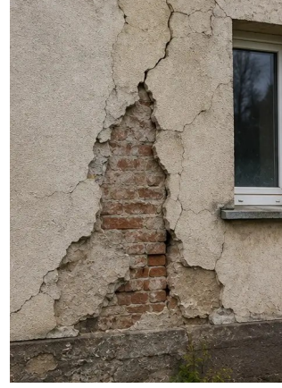
Photo #4. Değerlendirme için belgelenen dış duvar hasarı
