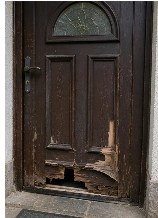
Photo #8. Denetim sırasında kaydedilen hasarlı giriş kapısı
