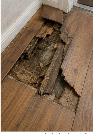
Photo #9. Denetim sırasında belgelenen hasarlı döşeme
