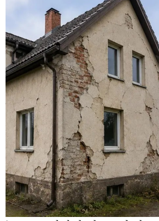
Photo #2. Denetim sırasında belgelenen dış hasarlara genel bakış
