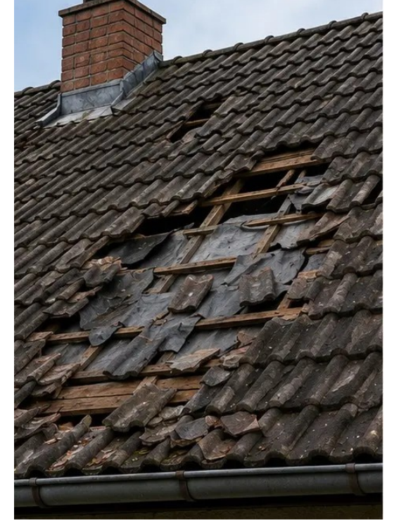
Görüntü No3 Hasarlı çatı alanı tespit edildi ve kaydedildi
