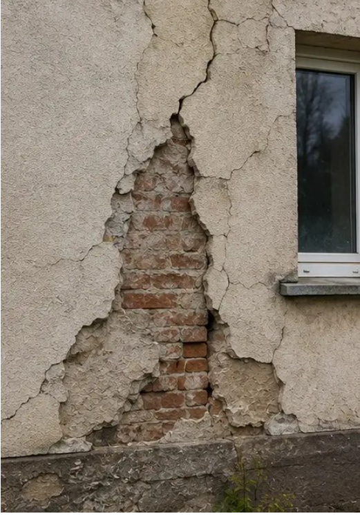
Görüntü No4 Değerlendirme için belgelenen dış duvar hasarı
