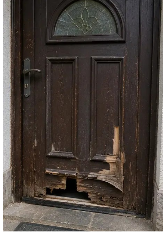
Görüntü No8 Denetim sırasında kaydedilen hasarlı giriş kapısı
