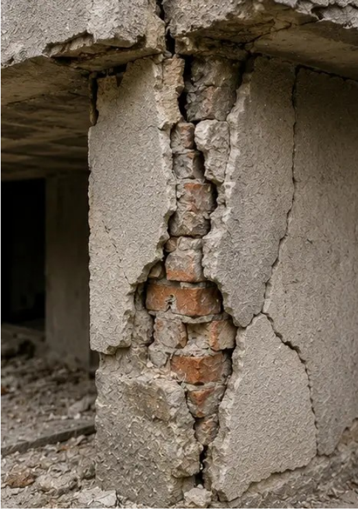
Görüntü No13 Değerlendirme için belgelenen yapısal hasar detayı
