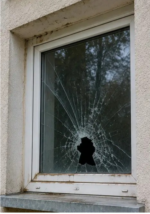
Görüntü No7 Değerlendirme için belgelenen hasarlı pencere
