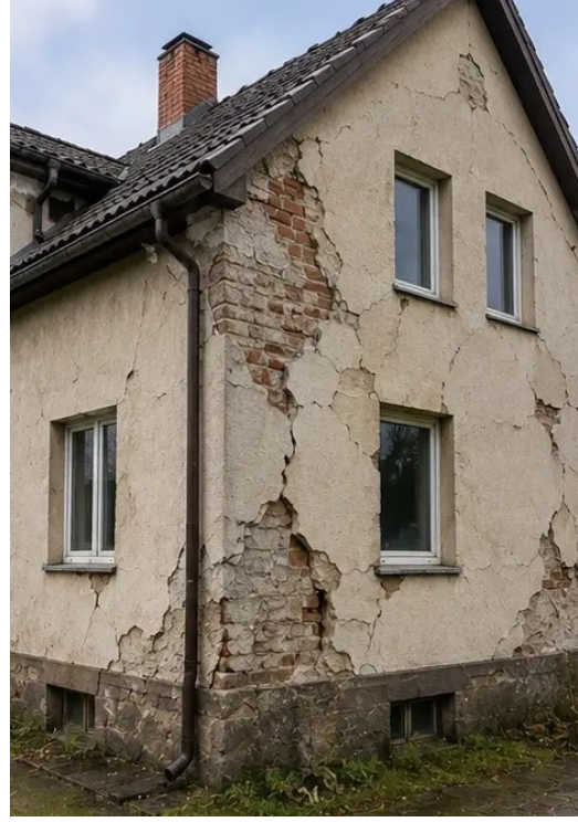
Görüntü No2 Denetim sırasında belgelenen dış hasarlara genel bakış
