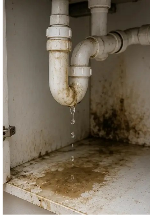
Görüntü No11 Sıhhi tesisat sızıntı hasarı belgelendi
