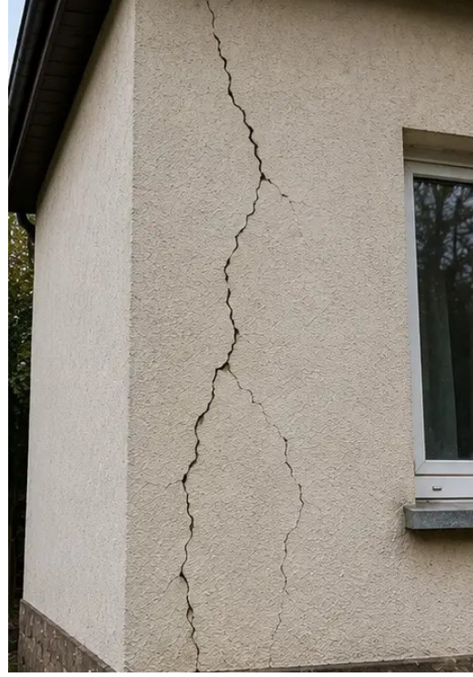
Görüntü No5 Denetim sırasında belgelenen taşıyıcı duvar çatlağı
