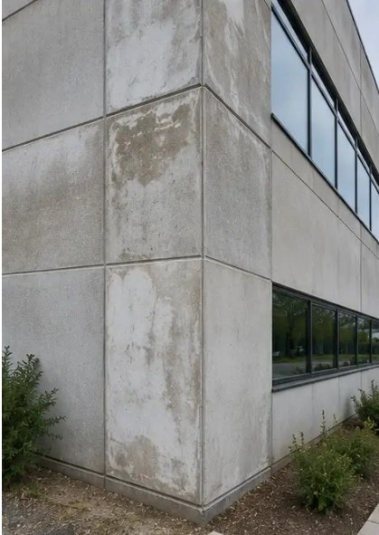
Photo #4. Denetim sırasında kaydedilen dış duvar durumu
