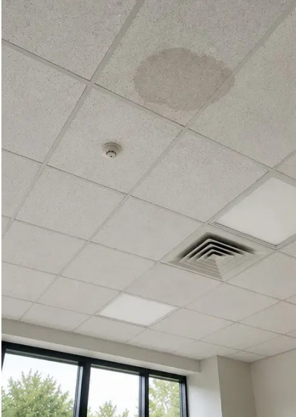
Photo #13. Denetim sırasında belgelenen tavan durumu
