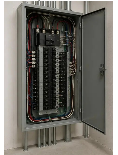
Photo #9. Elektrik panosu durumu belgelendi
