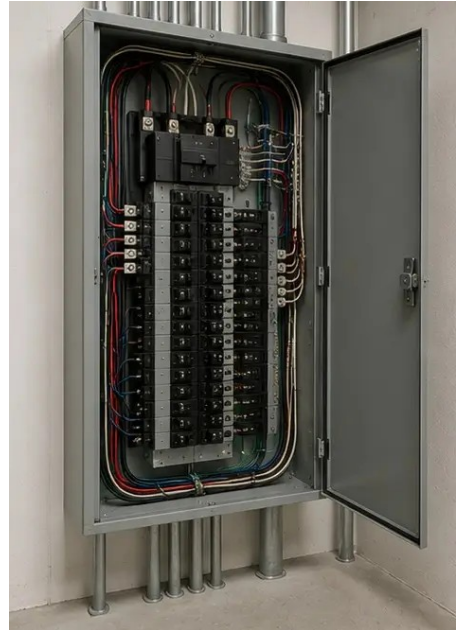
Photo #9. Elektrik panosu durumu belgelendi
