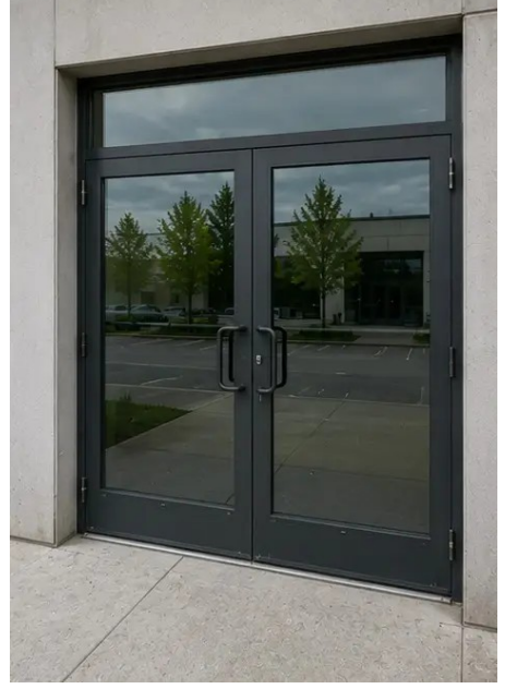
Photo #7. Kapı durumu denetlendi ve kaydedildi
