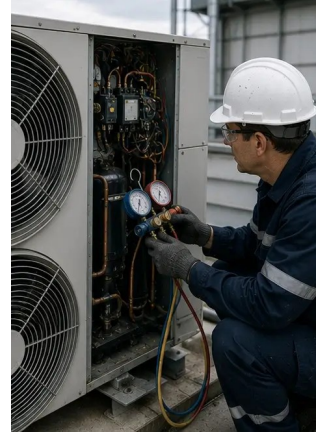
Görüntü No6. HVAC ekipmanı durumu belgelendi
