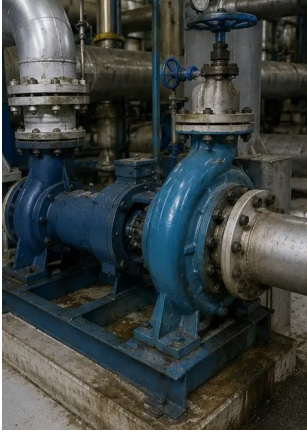
Görüntü No3. Bakım sırasında değerlendirilen endüstriyel pompa durumu
