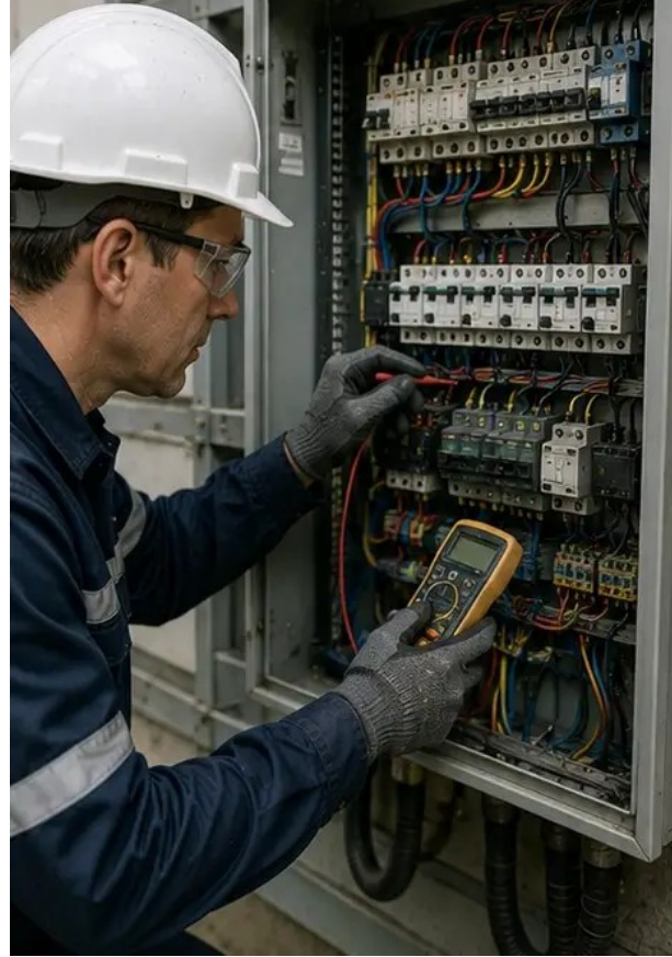
Görüntü No5. Elektrik panosu denetimi yapıldı
