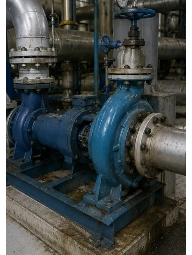
Görüntü No3. Bakım sırasında değerlendirilen endüstriyel pompa durumu
