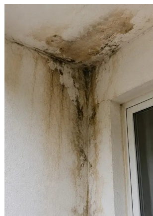
Photo #6. พื้นที่ความเสียหายจากน้ำระบุดและบันทึกแล้ว
