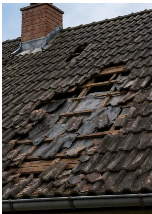
Photo #3. พื้นที่หลังคาที่เสียหายระบุดและบันทึกแล้ว
