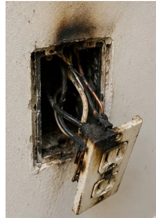
Photo #12. ความเสียหายระบบไฟฟ้าบันทึกระหว่างการตรวจสอบ
