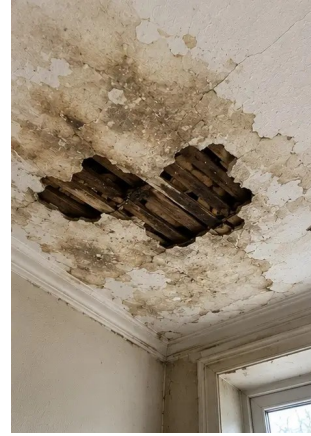
Photo #10. ความเสียหายฝ้าเพดานระลอกและบันทึกแล้ว
