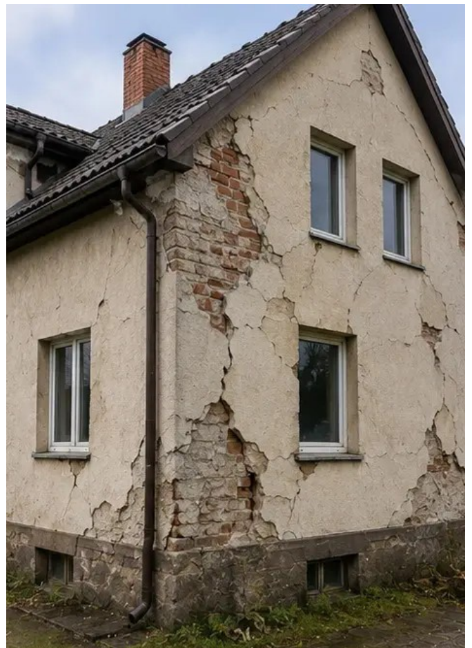
รูปภาพ №2 ภาพรวมความเสียหายภายนอกที่บันทึกระหว่างการตรวจสอบ
