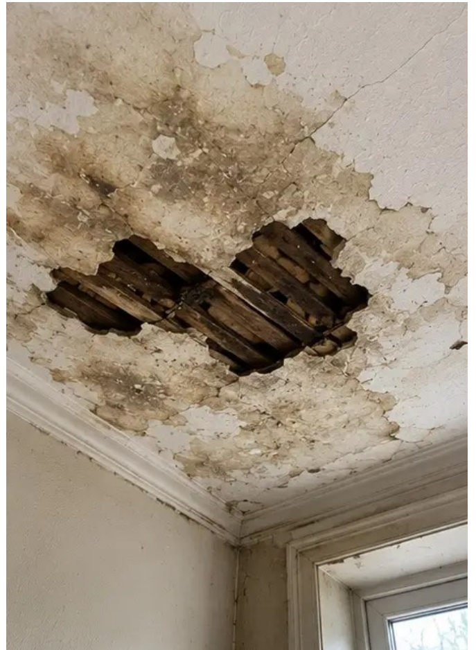
รูปภาพ №10 ความเสียหายฝ้าเพดานระบุและบันทึกแล้ว
