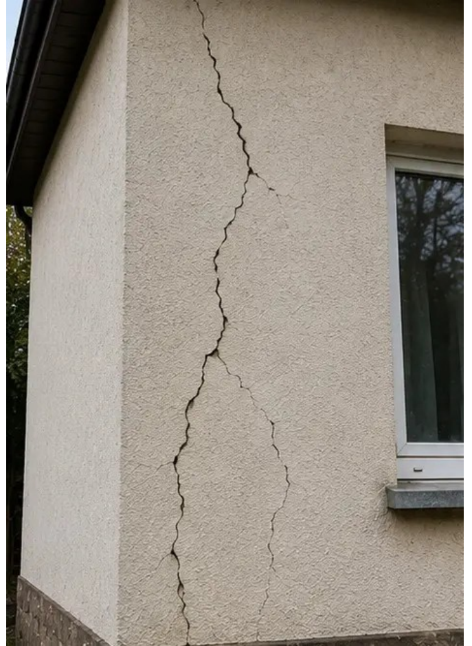
รูปภาพ №5 รอยร้าวในผนังโครงสร้างบ้นที่ระหว่างการตรวจสอบ
