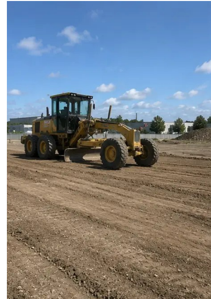
รูปภาพ №7. การก่อสร้างโครงสร้างกำลังดำเนิน
