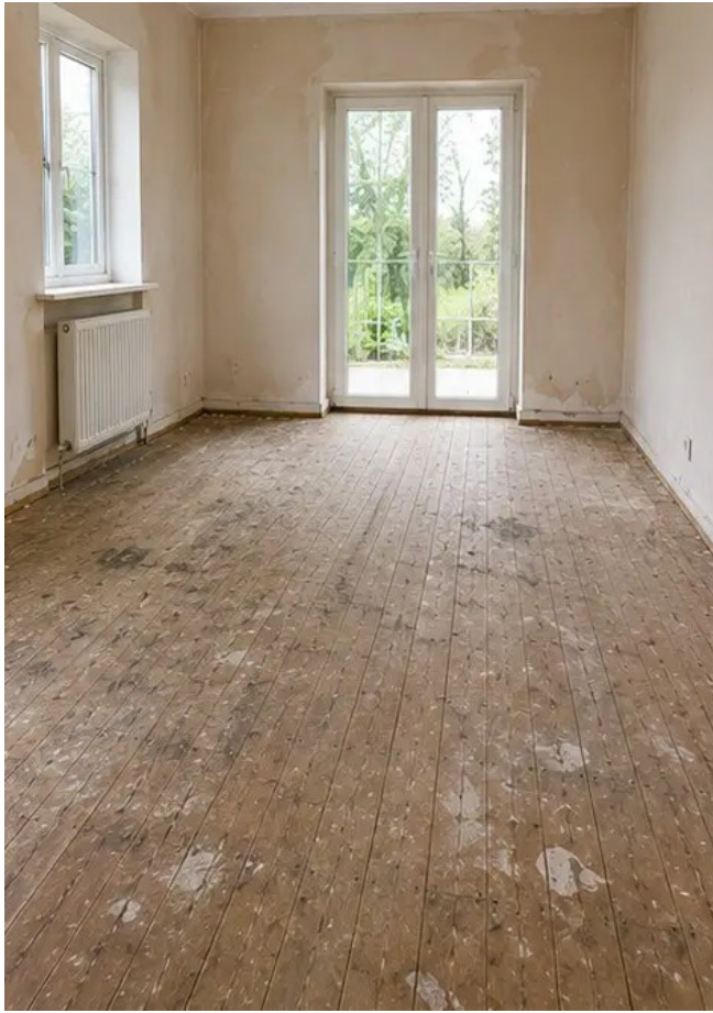
รูปภาพ №5 สภาพพื้นก่อนเปลี่ยน
