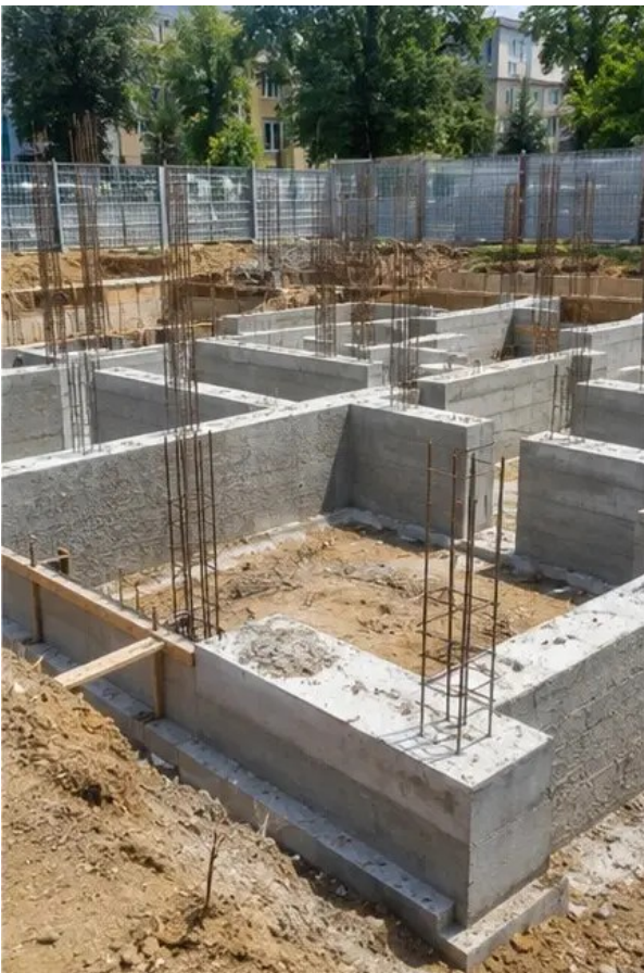
รูปภาพ №3 งานก่อสร้างฐานรากกำลังดำเนินการ
