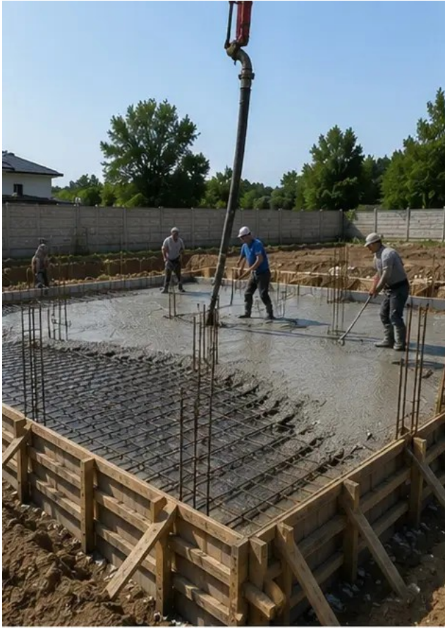
รูปภาพ №5 ดำเนินการเทคอนกรีตบนชิ้นส่วนฐานราก
