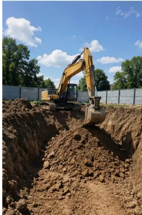
รูปภาพ №2 งานขุดดำเนินการตามข้อกำหนดโครงการ
