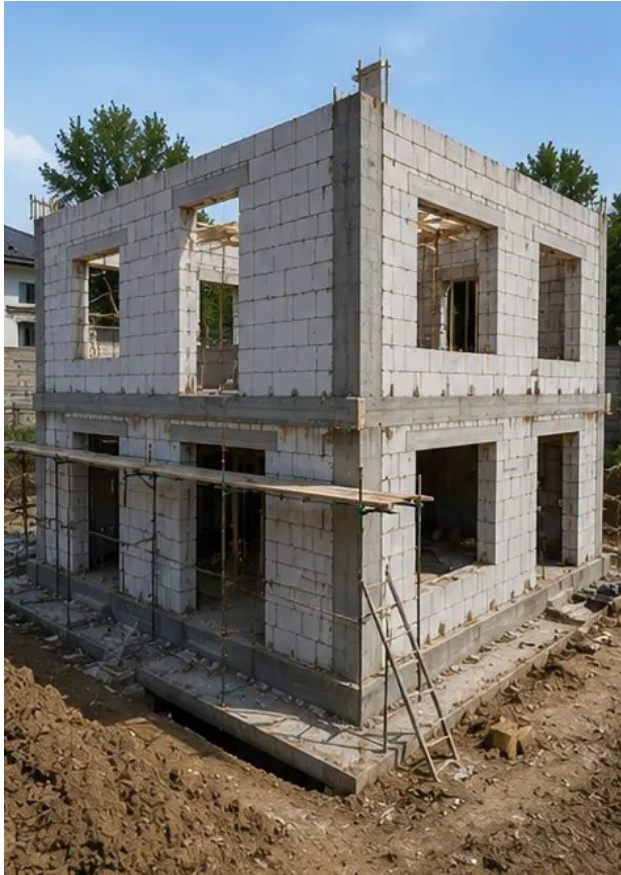
รูปภาพ №7 ก่อสร้างผนังภายนอกเสร็จในส่วนอาคาร
