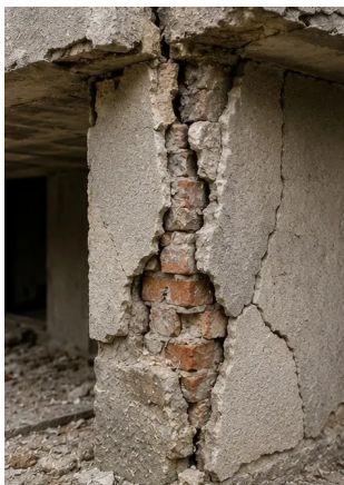
Photo #13. Detalj av konstruktionsskada dokumenterad för bedömning
