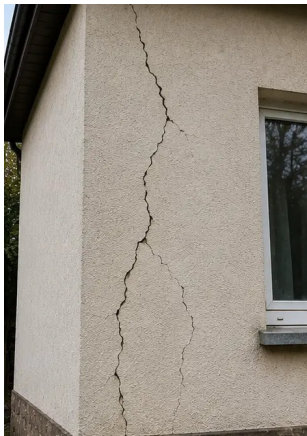
Photo #5. Spricka i bärande vägg dokumenterad under besiktning
