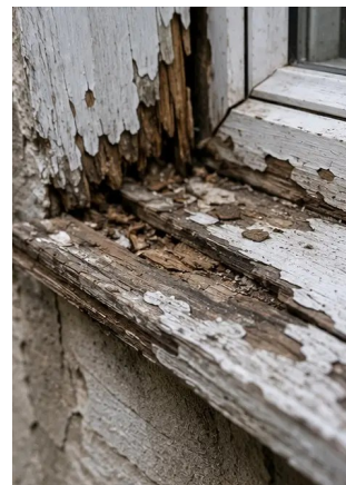
Photo #14. Närbild som bevis för identifierad skada
