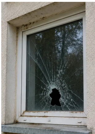
Photo #7. Skadat fönster dokumenterat för utvärdering
