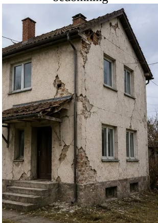
Photo #15. Översikt över flera skadeplatser
