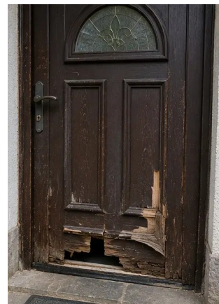
Photo #8. Skadad entrédörr registrerad under besiktning
