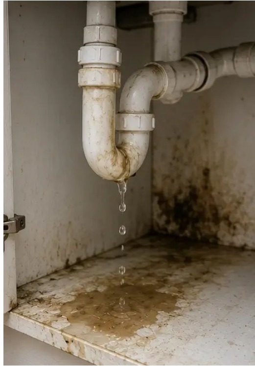
Fotografi nr11 Vattenläckageskada dokumenterad
