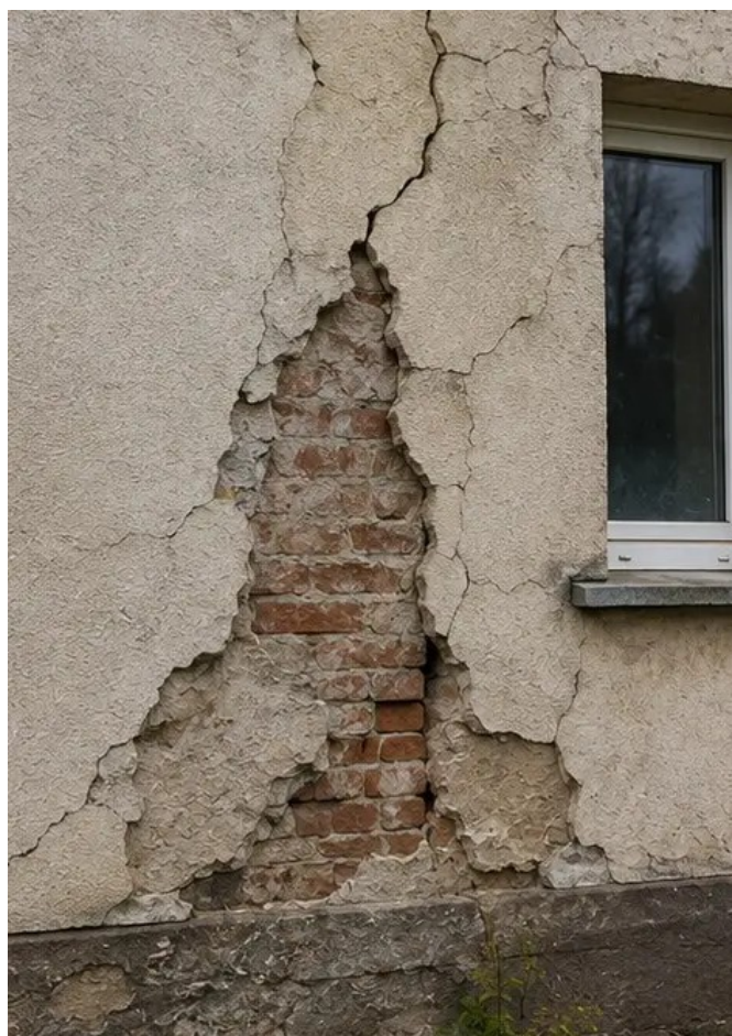
Fotografi nr4 Ytterväggsskada dokumenterad för bedömning
