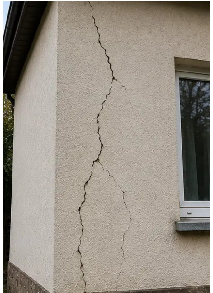
Fotografi nr5 Spricka i bärande vägg dokumenterad under besiktning
