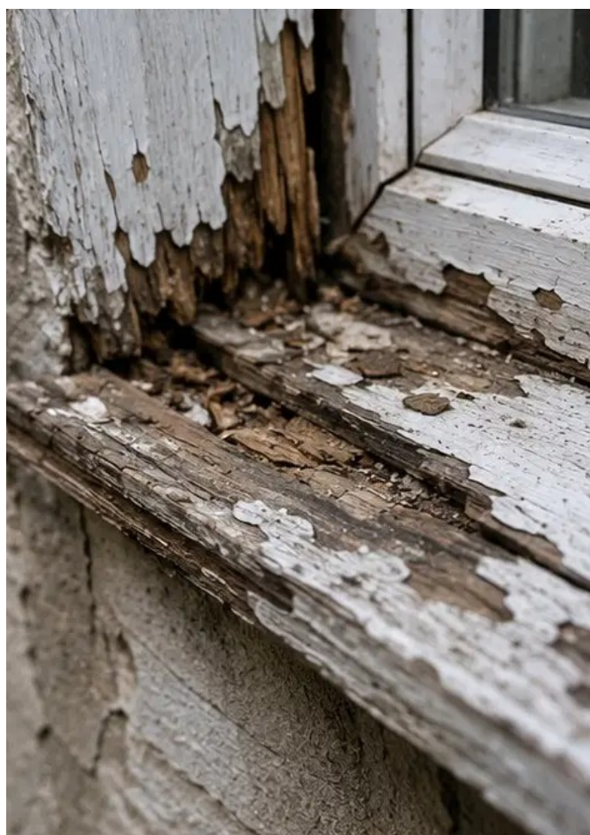
Fotografi nr14 Närbild som bevis för identifierad skada
