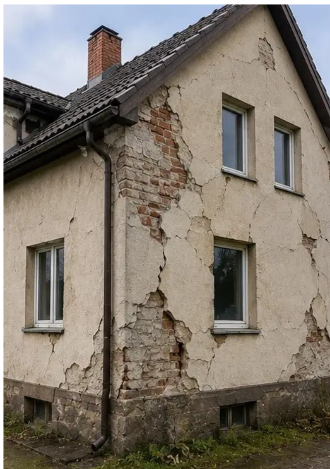
Fotografi nr2 Översikt av yttre skador dokumenterade under besikningen
