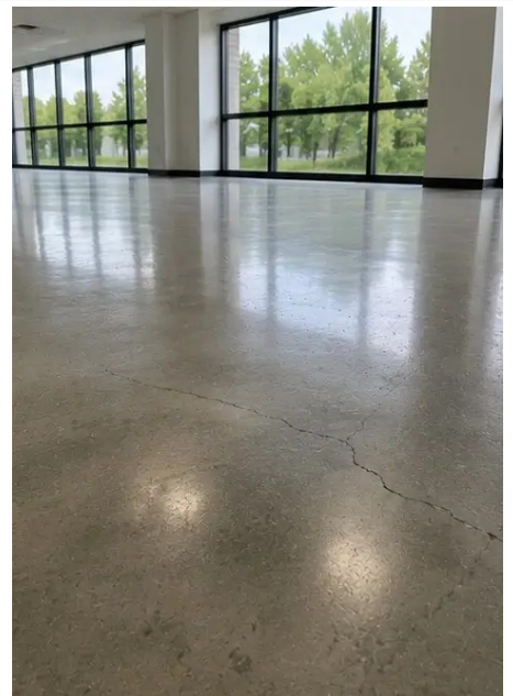
Photo #14. Golvets skick bedömt och registrerat
