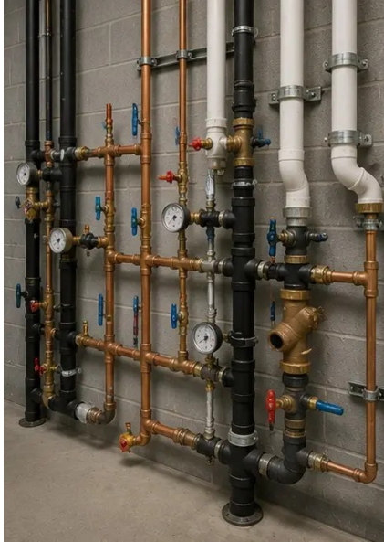
Photo #10. VVS-systembesiktning slutförd
