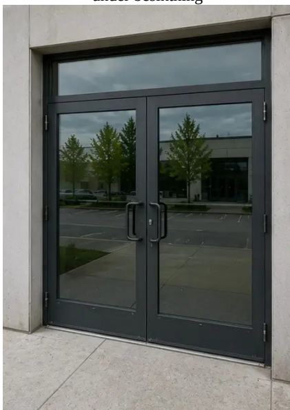
Photo #7. Dörrarnas skick besiktigat och registrerat
