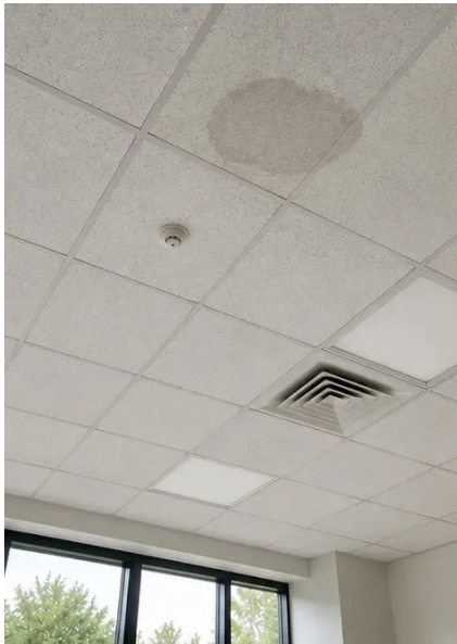
Photo #13. Takets skick dokumenterat under besiktning
