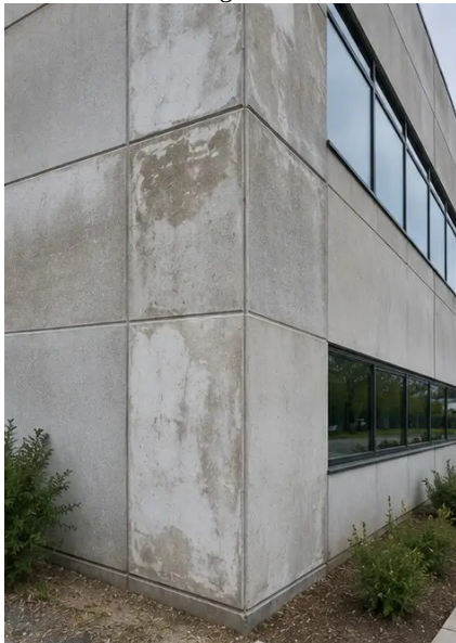
Photo #4. Ytterväggarnas skick registrerat under besiktning
