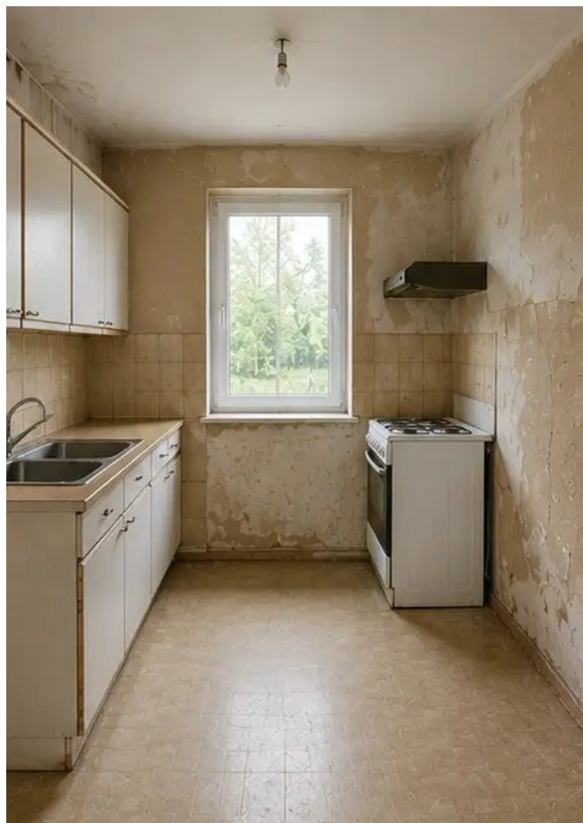
Fotografi nr11 Kökets skick före renovering
