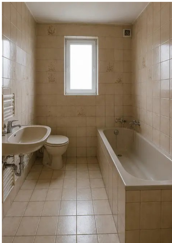
Fotografi nr9 Badrummets skick före renovering
