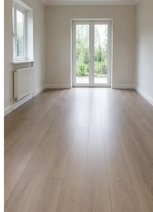
Fotografi nr6 Golvets skick efter byte
