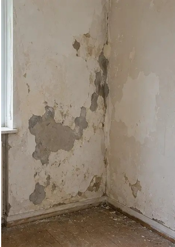
Fotografi nr3 Väggens skick före reparationsarbete
