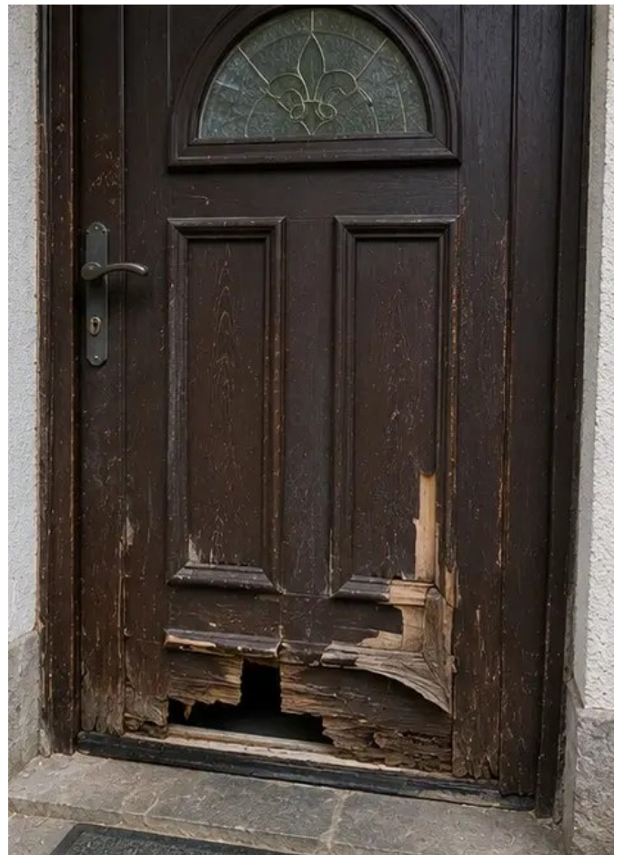
Слика бр.8 Оштећена улазна врата забележена током инспекције
