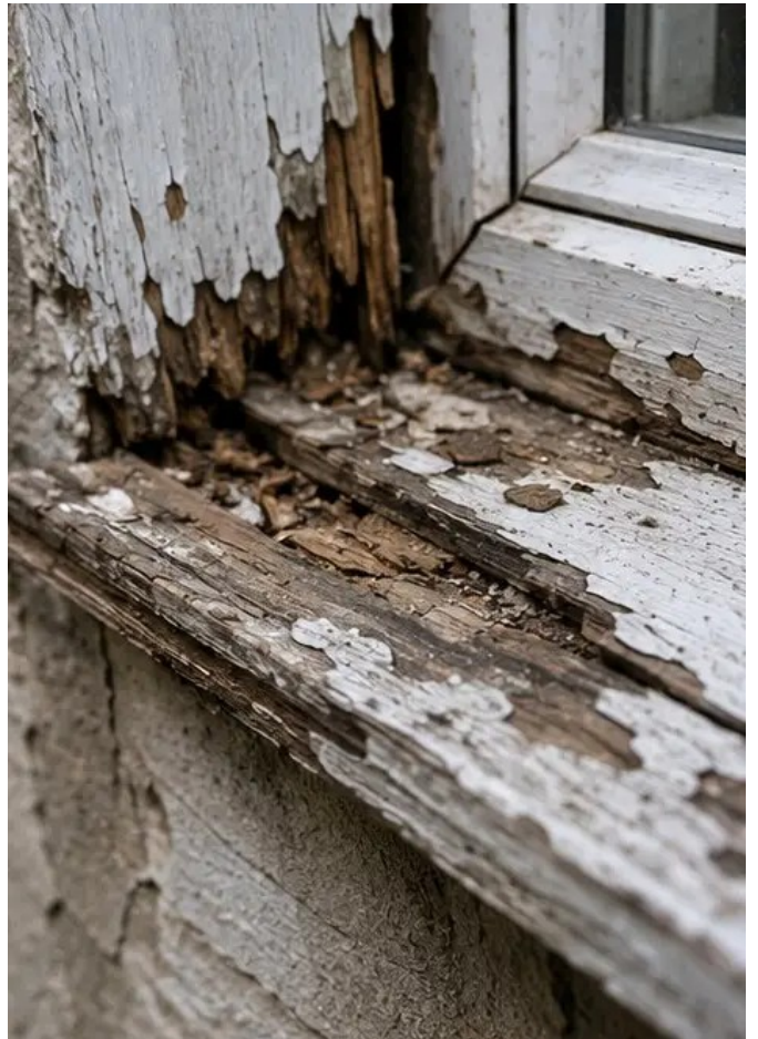
Слика бр.14 Фотографија изблиза идентификованог оштећења као доказ
