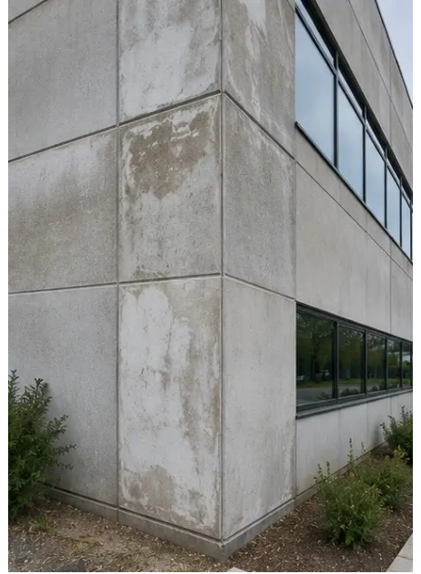
Photo #4. Стање спољних зидова забележено током инспекције
