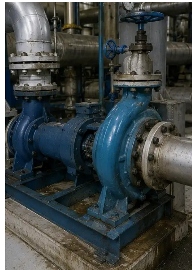
Слика бр.3. Стање индустријске пумпе процењено током одржавања
