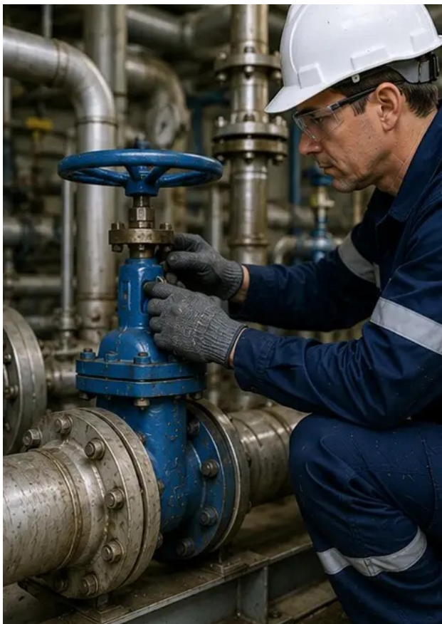
Слика бр.10. Стање вентила процењено током прегледа
