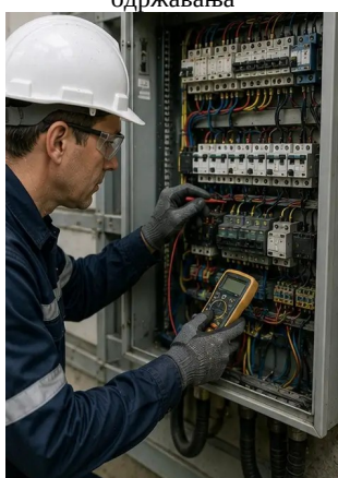
Слика бр.5. Преглед електричног ормара обављен
