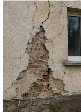
Photo #4. Dëmtimi i murit të jashtëm i dokumentuar për vlerësim
