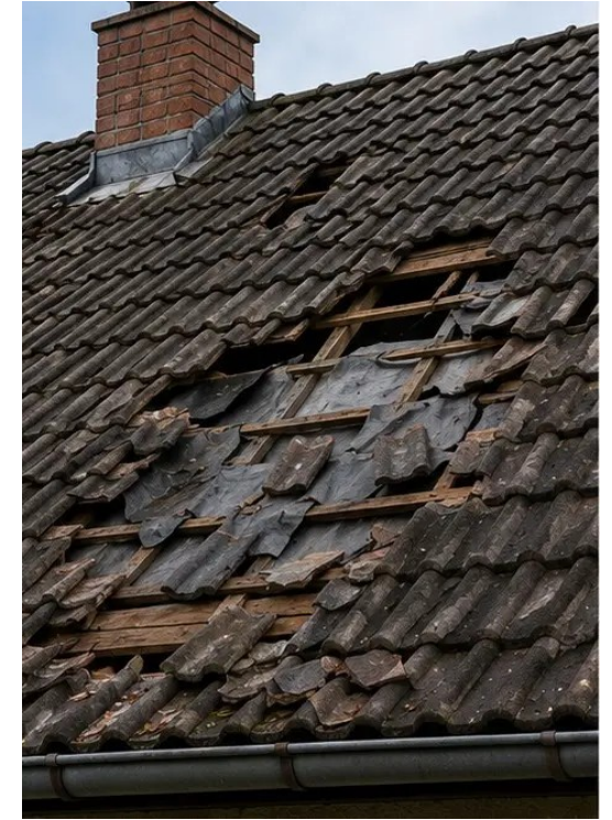
Foto Nr.3 Zona e çatisë së dëmtuar e identifikuar dhe regjistruar
