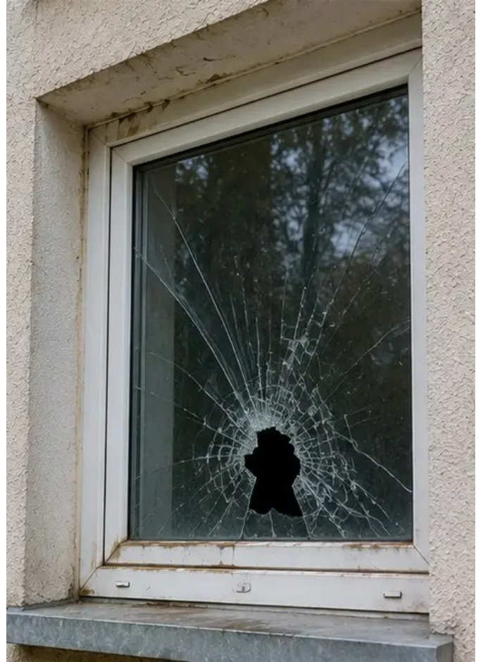
Foto Nr.7 Dritarja e dëmtuar e dokumentuar për vlerësim
