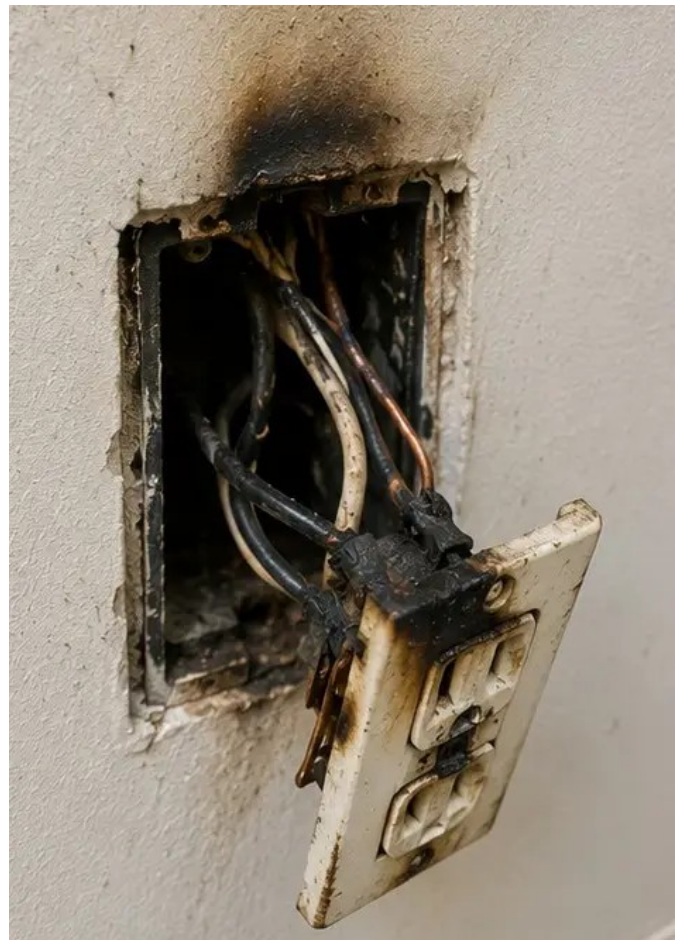
Foto Nr.12 Dëmtimi i sistemit elektrik i regjistruar gjatë inspektimit
