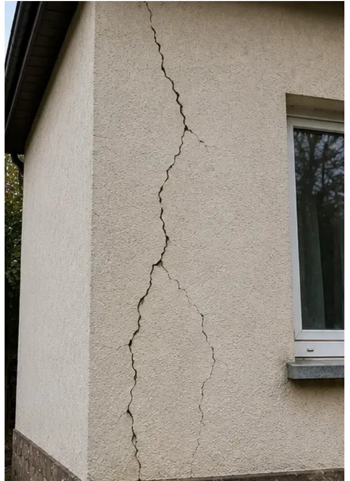
Foto Nr.5 Çarje në mur strukturor e dokumentuar gjatë inspektimit
