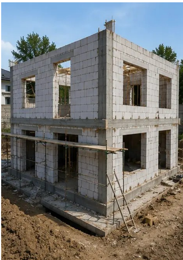
Foto Nr.7 Ndërtimi i mureve të jashtme përfundoi për seksionin e ndërtesës
