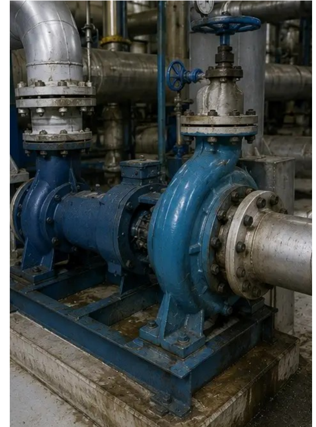
Foto Nr.3. Gjendja e pompës industriale e vlerësuar gjatë mirëmbajtjes
