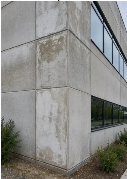
Photo #4. Gjendja e mureve të jashtme e regjistruar gjatë inspektimit
