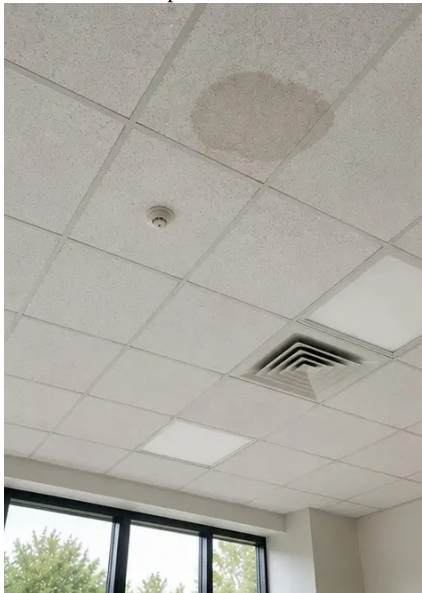
Photo #13. Gjendja e tavanit e dokumentuar gjatë inspektimit
