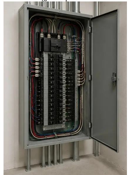
Photo #9. Gjendja e panelit elektrik e dokumentuar
