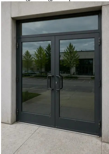
Photo #7. Gjendja e dyerve e inspektuar dhe regjistruar
