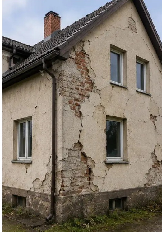
Foto št.2 Pregled zunanjih poškodb, dokumentiranih med pregledom
