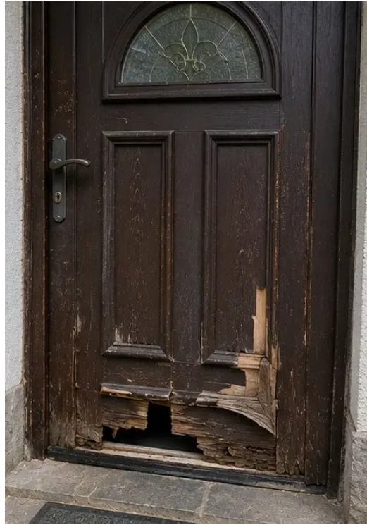
Foto št.8 Poškodovana vhodna vrata zabeležena med pregledom
