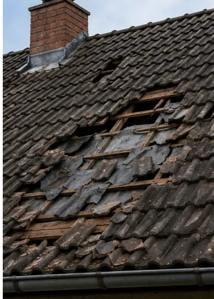
Photo #3. Poškodovano območje strehe identificirano in zabeleženo
