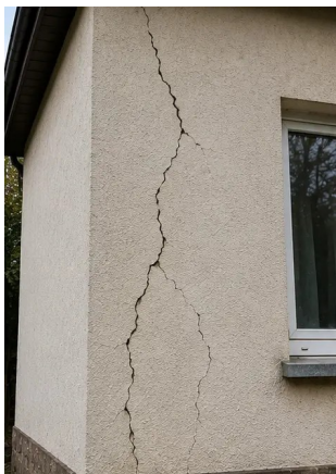
Photo #5. Razpoka v nosilni steni dokumentirana med pregledom
