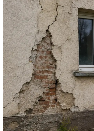
Photo #4. Poškodba zunanje stene dokumentirana za oceno
