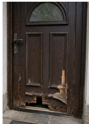
Photo #8. Poškodovana vhodna vrata zabeležena med pregledom
