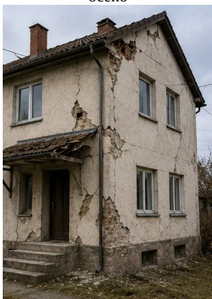
Photo #15. Pregled več lokacij poškodb
