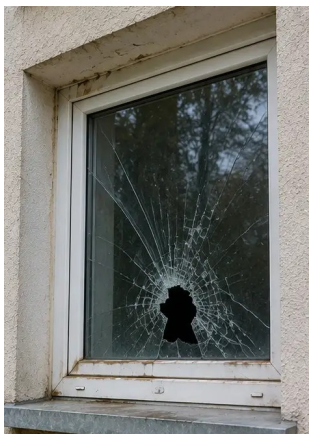
Photo #7. Poškodovano okno dokumentirano za ovrednotenje
