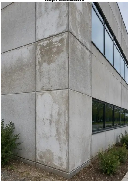
Photo #4. Stanje zunanjih sten zabeleženo med pregledom
