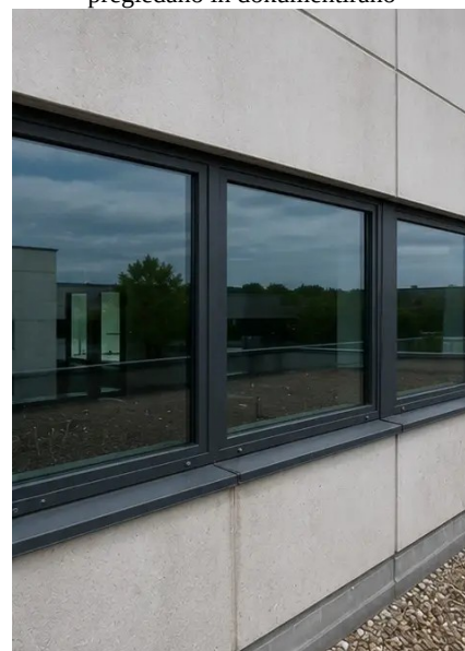
Photo #6. Stanje oken dokumentirano med pregledom
