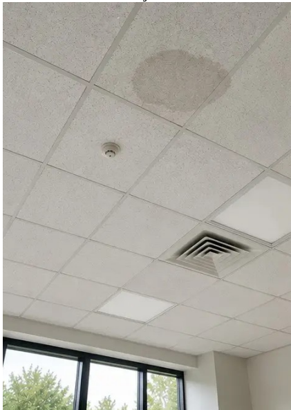
Photo #13. Stanje stropa dokumentirano med pregledom
