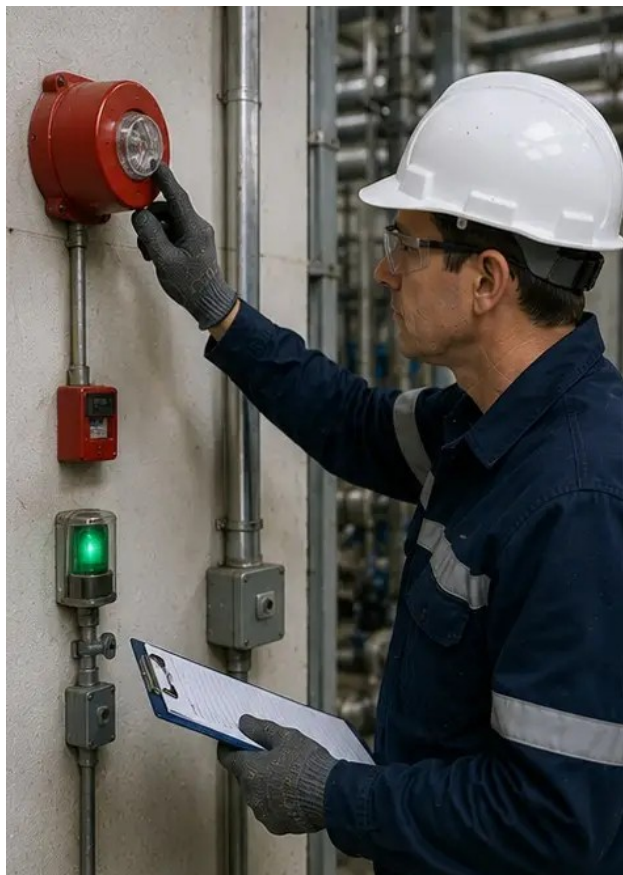
Foto št.13. Pregled varnostnega sistema zaključen
