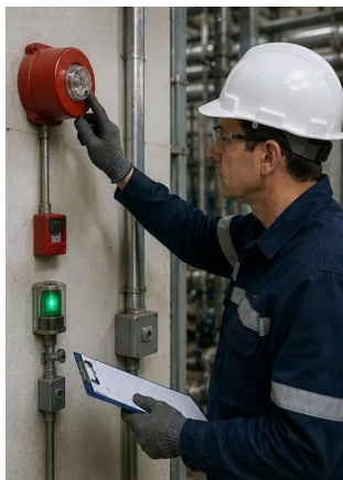
Foto št.13. Pregled varnostnega sistema zaključen
