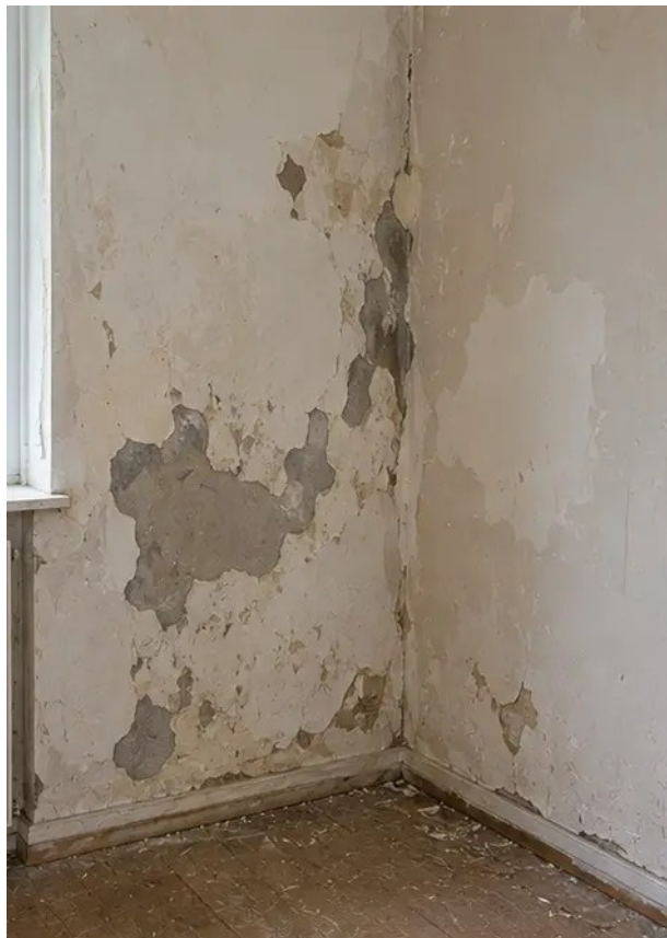
Foto št.3 Stanje stene pred popravilom
