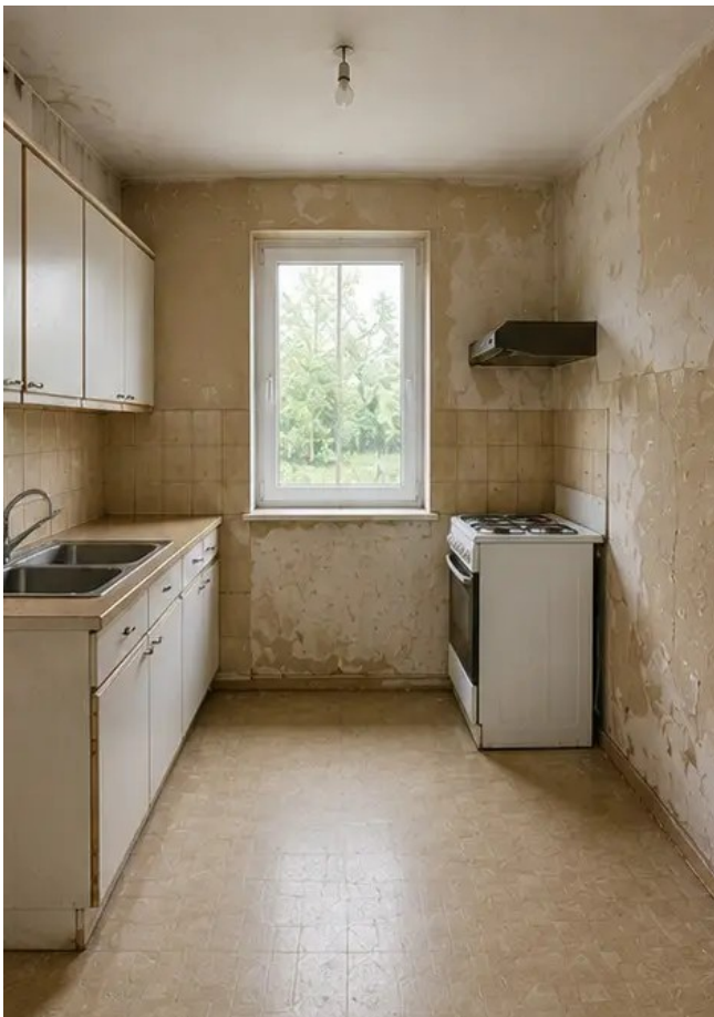
Foto št.11 Stanje kuhinje pred prenovno
